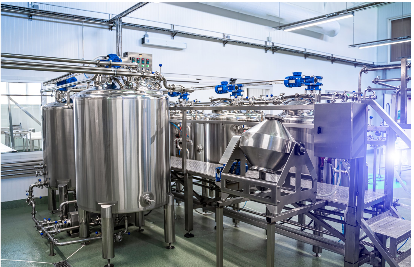
Figura 1 — Apparecchiature per il trattamento dei prodotti lattiero-caseari con serbatoi CIP
